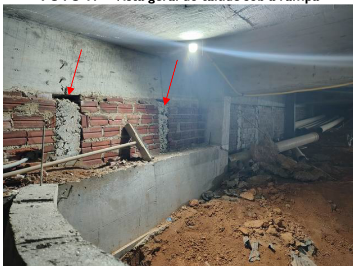
FOTO 20 – Vista geral da divisa esquerda com falhas em concretagens (a serem tratadas na sequência)
