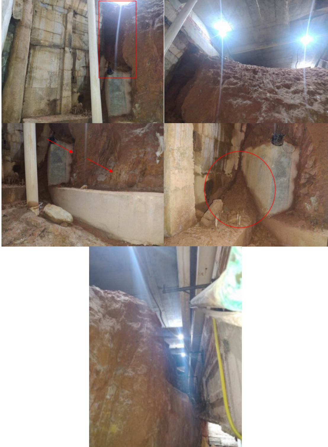
Erosão do terreno e ausência de muro de contenção
