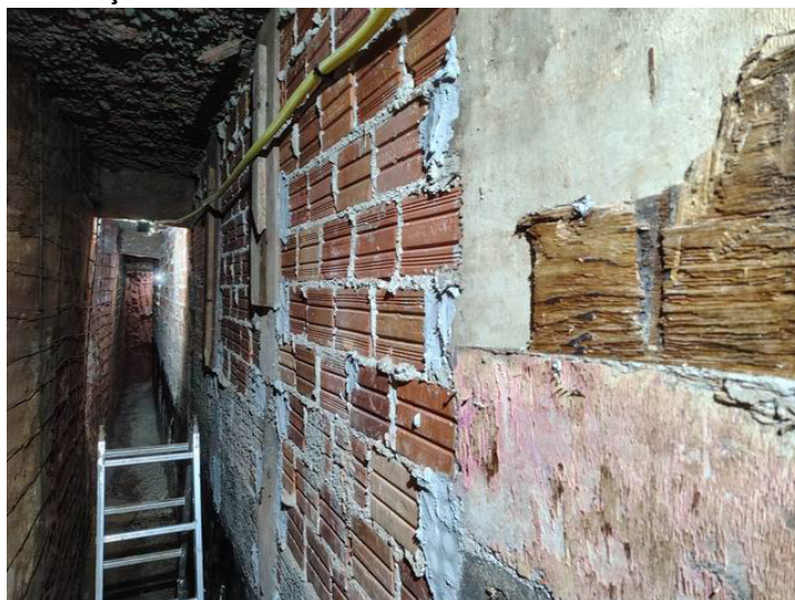
FOTO 05 – Parede da Sala do Arquivo Inativo receberá impermeabilização e emboço
