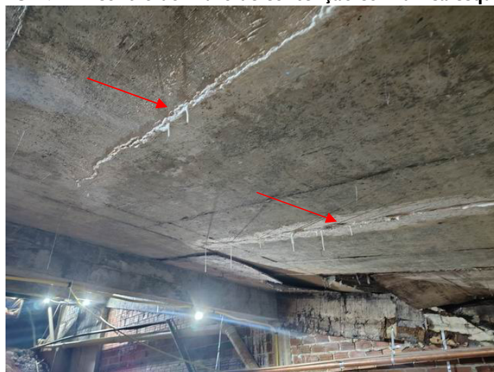
FOTO 18 – Infiltrações de umidade na laje de teto ainda a serem tratadas
