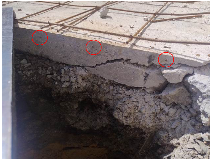
FOTO 04 – Laje apenas com armaduras superiores, apoiada diretamente no terreno
