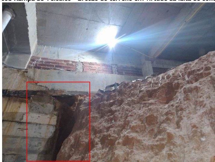
FOTO 18 – Subsolo sob Rampa de Veículos – Parte do terreno erodido em virtude de infiltração no local
