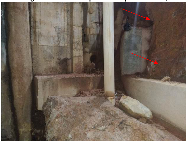
FOTO 11 – Subsolo sob Rampa de Veículos – Ausência de muro de arrimo para contenção do terreno
