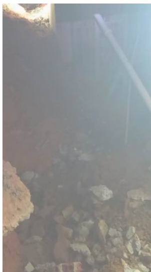
FOTO 62 – Subsolo sob Rampa de Veículos – Erosão recente causada por chuva intensa
