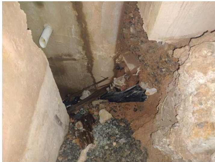
FOTO 40 – Subsolo sob a Rampa de Veículos – Erosão do terreno junto à divisa esquerda
