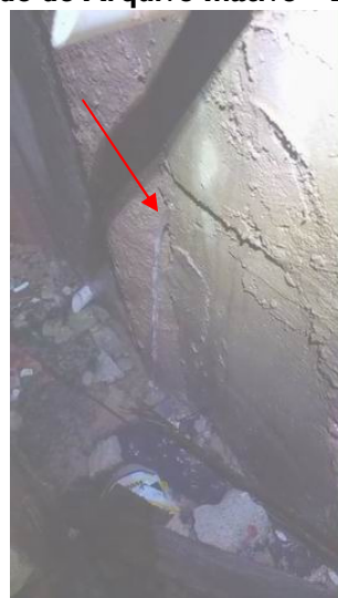
FOTO 54 – Subsolo sob Rampa de Veículos – Infiltração recorrente na contenção atrás da garagem
