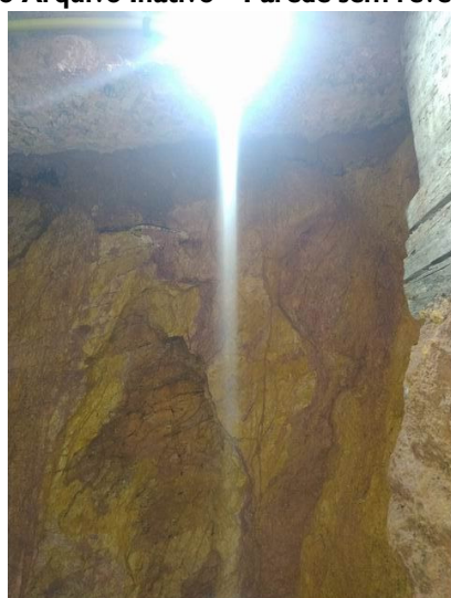
FOTO 29 – Subsolo ao lado do Arquivo Inativo – Terreno lateral ao corredor sem contenção
