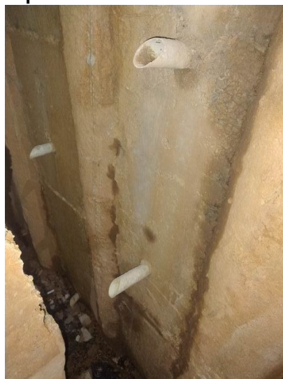
FOTO 41 – Subsolo sob a Rampa de Veículos – Divisa esquerda com sinais de umidade
