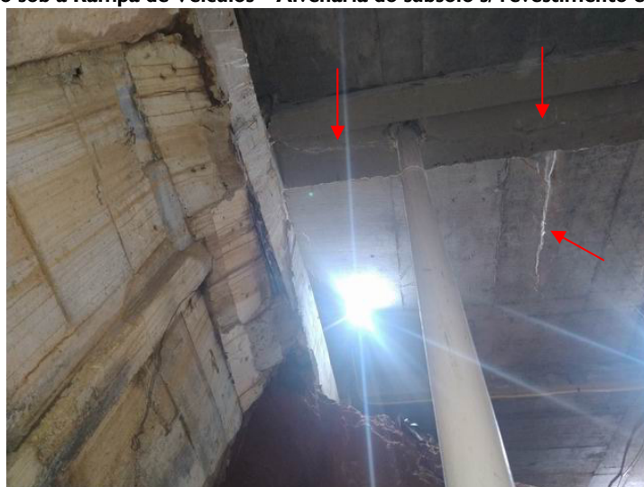
FOTO 45 – Subsolo sob a Rampa de Veículos – Sinais de infiltrações de umidade sob a rampa
