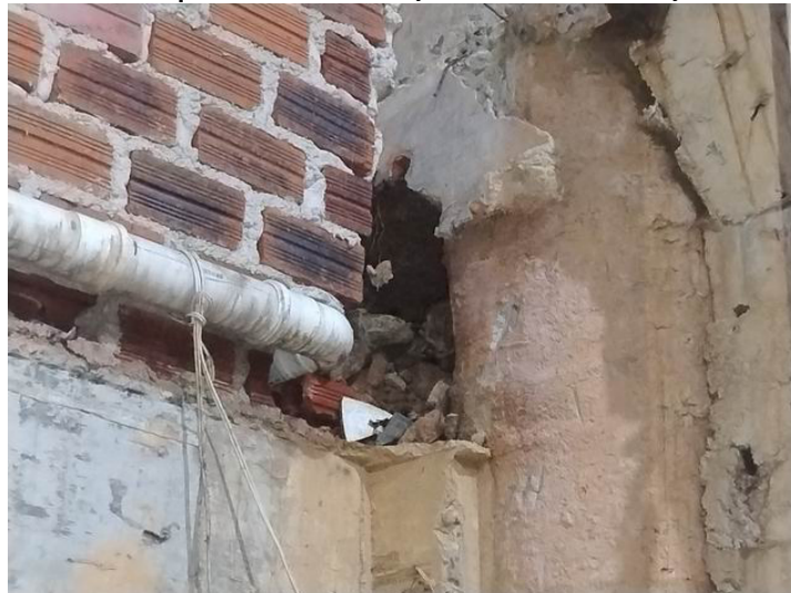
FOTO 38 – Subsolo sob a Rampa de Veículos – Buraco existente junto à contenção
