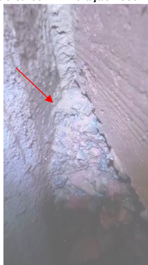
FOTO 56 – Subsolo sob Rampa de Veículos – Infiltração recorrente na contenção atrás da garagem
