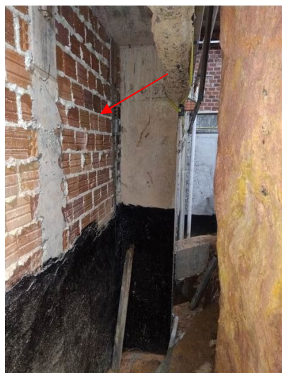
FOTO 28 – Subsolo ao lado do Arquivo Inativo – Parede sem revestimento e impermeabilização
