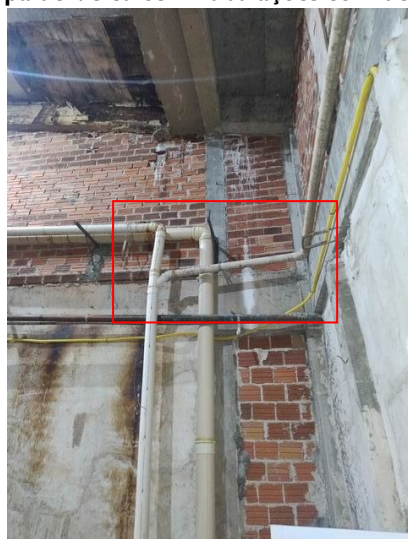
FOTO 47 – Subsolo sob a Rampa de Veículos – Tubulações com deficiência de fixação/travamento
