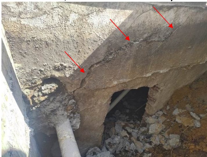
FOTO 09 – Rachadura em viga da estrutura de apoio da rampa de veículos, ao lado da futura Guarita
