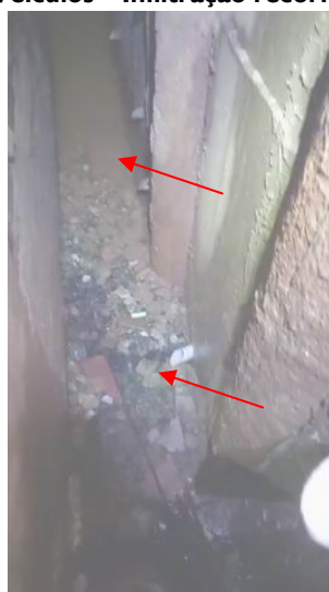
FOTO 57 – Subsolo sob Rampa de Veículos – Infiltração recorrente na contenção atrás da garagem
