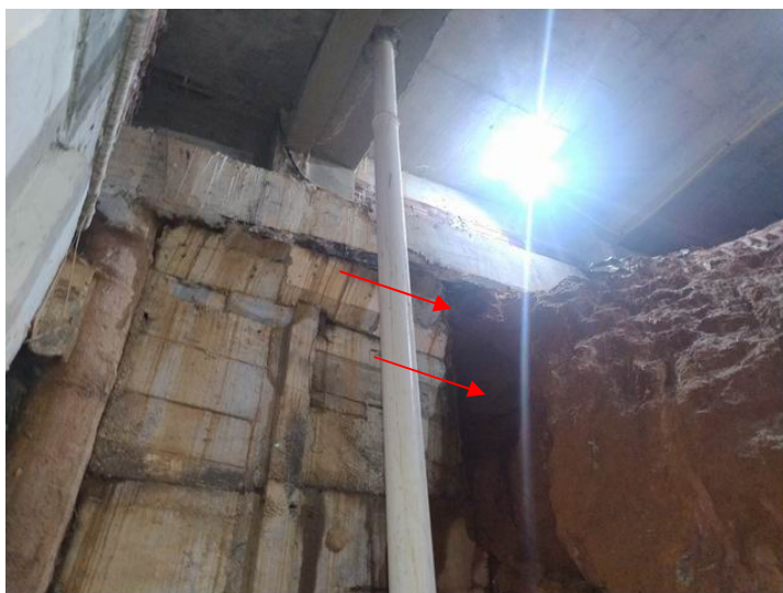
FOTO 13 – Subsolo sob Rampa de Veículos – Parte do terreno erodido em virtude de infiltração no local
