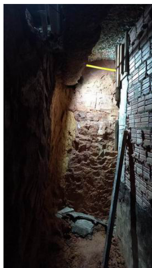
FOTO 52 – Subsolo ao lado do Arquivo Inativo – Erosão recente do terreno
