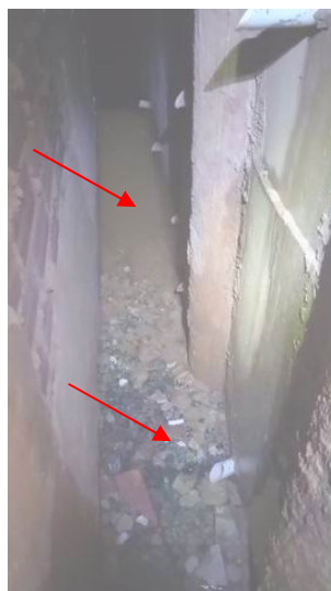
FOTO 58 – Subsolo sob Rampa de Veículos – Infiltração recorrente na contenção atrás da garagem
