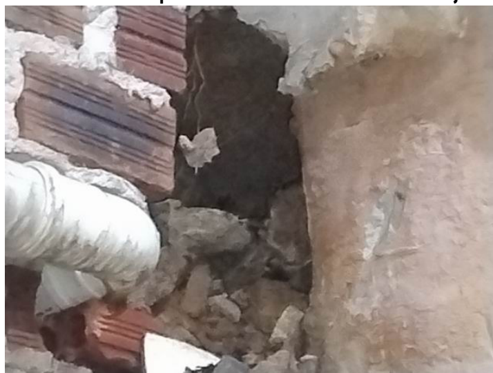
FOTO 39 – Subsolo sob a Rampa de Veículos – Buraco existente junto à contenção
