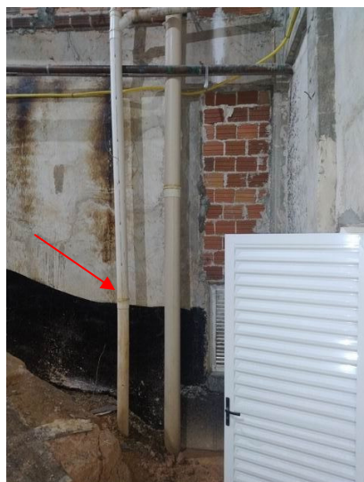
FOTO 46 – Subsolo sob a Rampa de Veículos – Tubulações com deficiência de fixação/travamento
