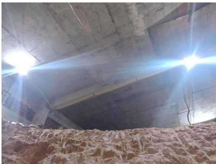
FOTO 19 – Subsolo sob Rampa de Veículos – Ausência de muro de arrimo para contenção do terreno
