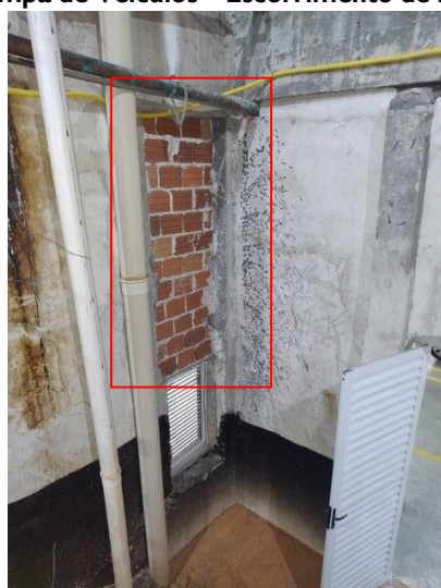
FOTO 21 – Subsolo sob Rampa de Veículos – Trecho no lado direito sem emboço e impermeabilização
