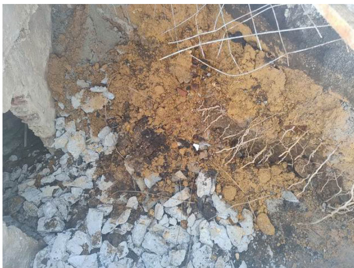
FOTO 07 – Erosão do terreno, afetando a estabilidade da laje diretamente apoiada
