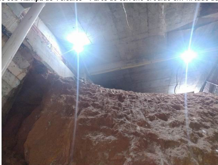
FOTO 14 – Subsolo sob Rampa de Veículos – Ausência de muro de arrimo para contenção do terreno
