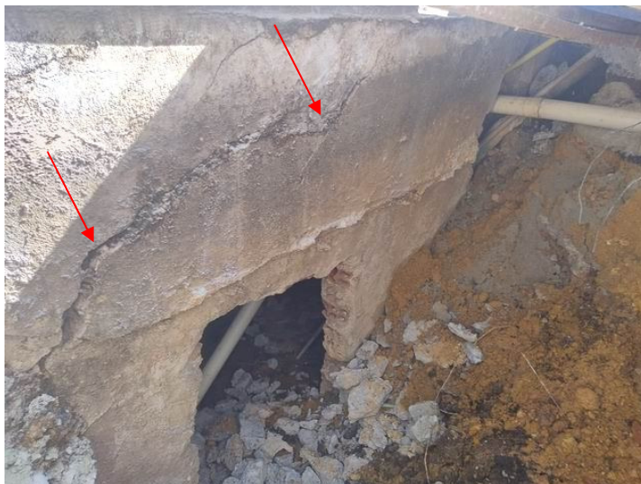
FOTO 10 – Rachadura em viga da estrutura de apoio da rampa de veículos, ao lado da futura Guarita
