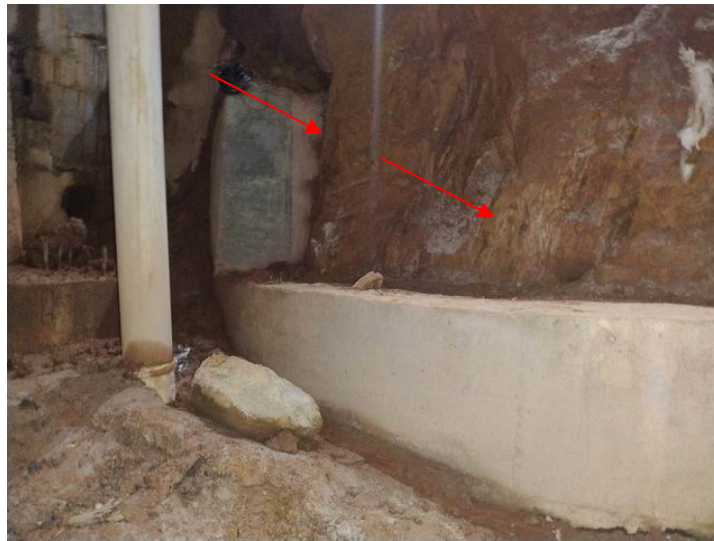
FOTO 16 – Subsolo sob Rampa de Veículos – Ausência de muro de arrimo para contenção do terreno
