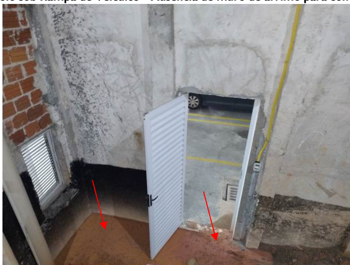
FOTO 20 – Subsolo sob Rampa de Veículos – Escorrimento de solos junto à porta de acesso
