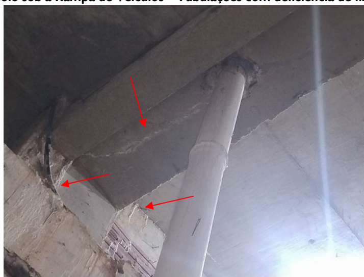
FOTO 48 – Subsolo sob a Rampa de Veículos – Sinais de infiltrações de umidade sob a rampa
