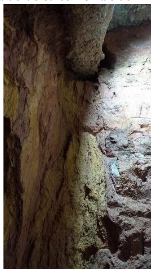
FOTO 50 – Subsolo ao lado do Arquivo Inativo – Erosão recente do terreno
