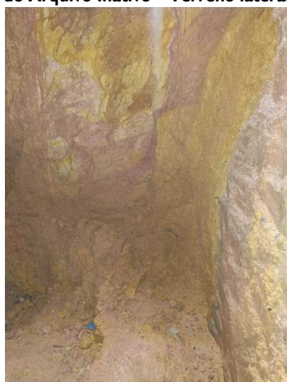
FOTO 30 – Subsolo ao lado do Arquivo Inativo – Terreno lateral ao corredor sem contenção
