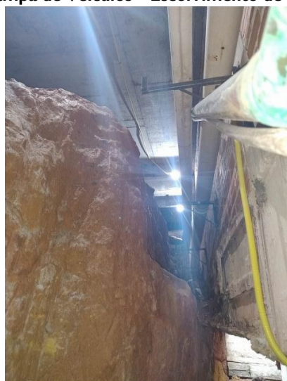
FOTO 23 – Subsolo sob Rampa de Veículos – Ausência de contenção do terreno, lado direito
