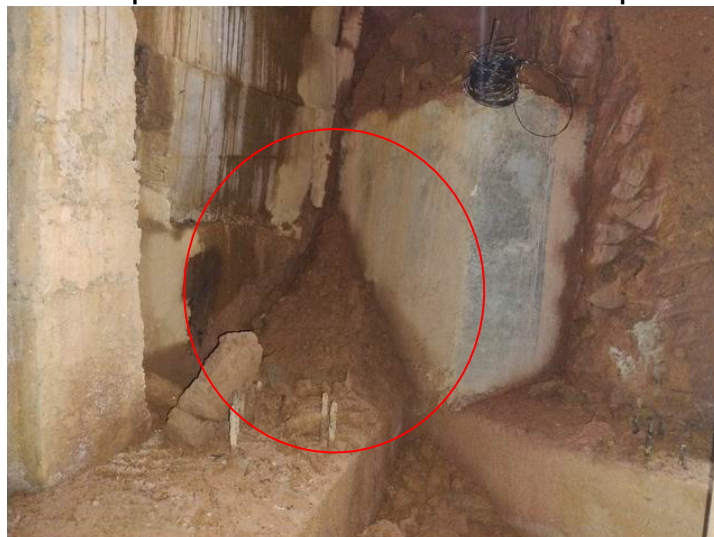
FOTO 17 – Subsolo sob Rampa de Veículos – Erosão do terreno em virtude da falta de contenção, lado esquerdo
