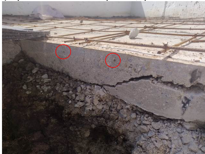
FOTO 05 – Laje apenas com armaduras superiores, apoiada diretamente no terreno
