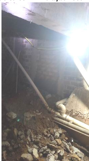
FOTO 59 – Subsolo sob Rampa de Veículos – Erosão recente causada por chuva intensa
