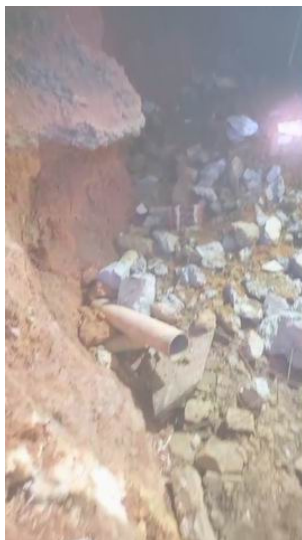
FOTO 61 – Subsolo sob Rampa de Veículos – Erosão recente causada por chuva intensa
