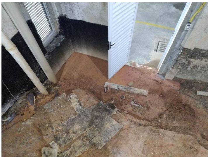
FOTO 22 – Subsolo sob Rampa de Veículos – Escorrimento de solos junto à porta de acesso
