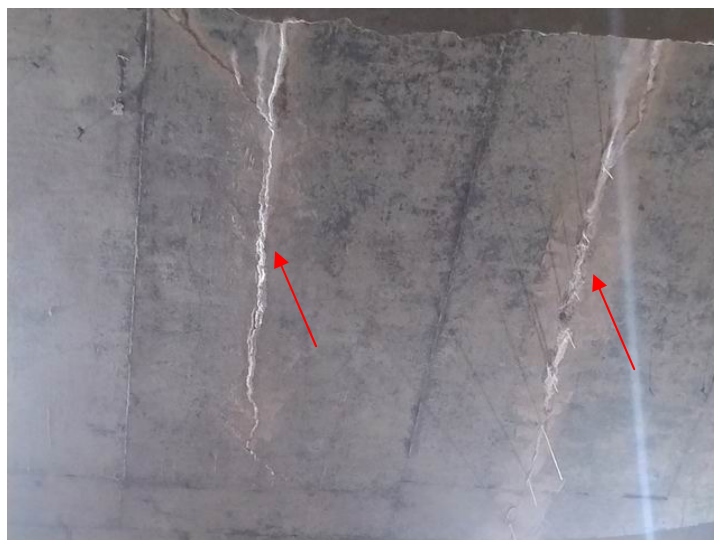
FOTO 49 – Subsolo sob a Rampa de Veículos – Sinais de infiltrações de umidade sob a rampa
