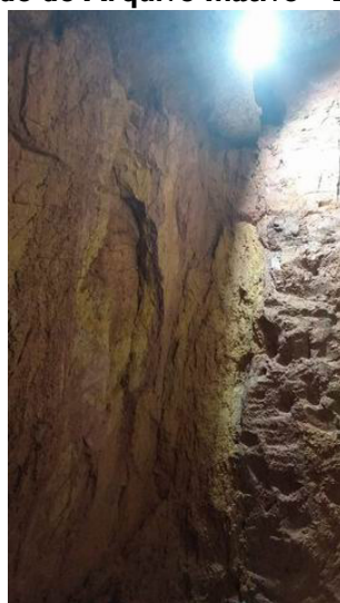
FOTO 53 – Subsolo ao lado do Arquivo Inativo – Erosão recente do terreno
