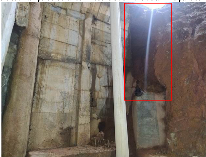
FOTO 12 – Subsolo sob Rampa de Veículos – Ausência de muro de arrimo para contenção do terreno
