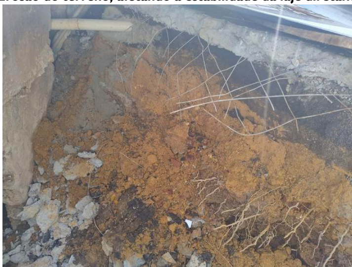
FOTO 08 – Erosão do terreno, afetando a estabilidade da laje diretamente apoiada
