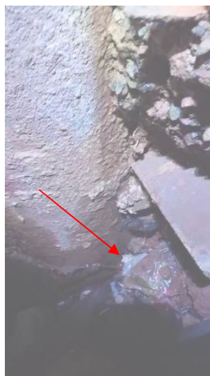
FOTO 55 – Subsolo sob Rampa de Veículos – Infiltração recorrente na contenção atrás da garagem
