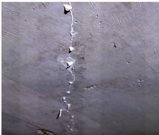
Efflorescência (gotejamento frequente)
