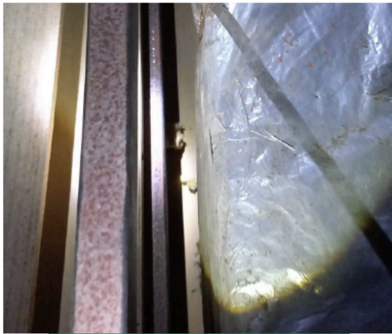
Suportes metálicos do forro oxidados
