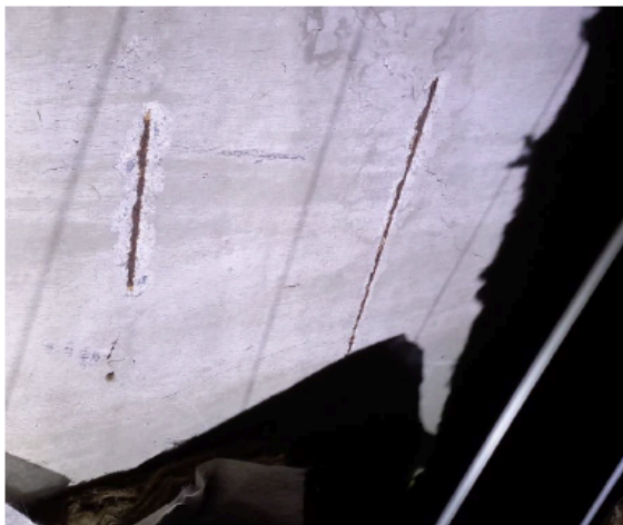
Oxidação da ferragem do teto
