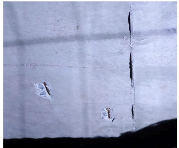
Oxidação da ferragem do teto
