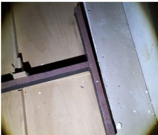
Suportes metálicos do forro oxidados
