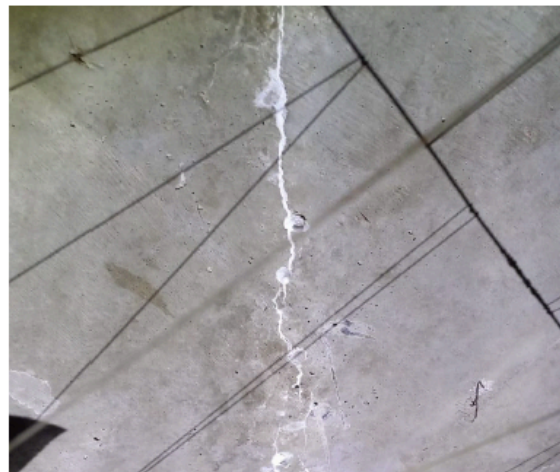
Efflorescência (gotejamento frequente)
