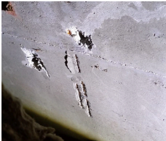
Oxidação da ferragem do teto
