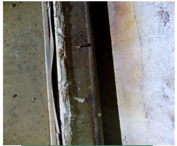
Perfis de drywall comprometidos (oxidados)
