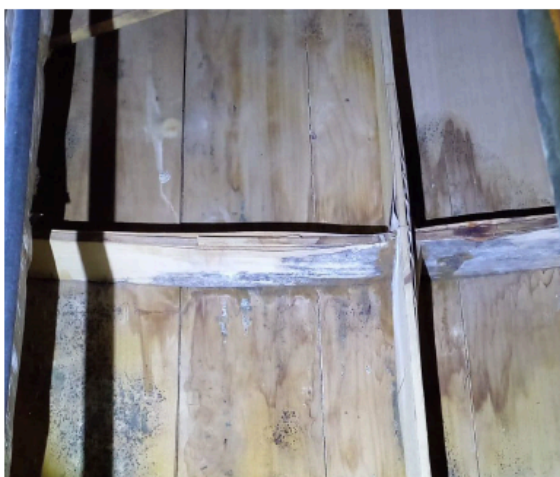
Forro e estrutura de madeira apodrecido
