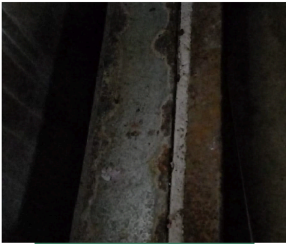
Perfis de drywall comprometidos (oxidados)
