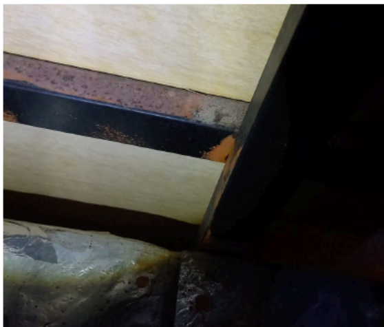
Suportes metálicos do forro oxidados
