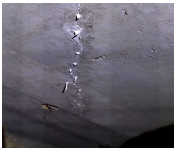
Efflorescência (gotejamento frequente)
