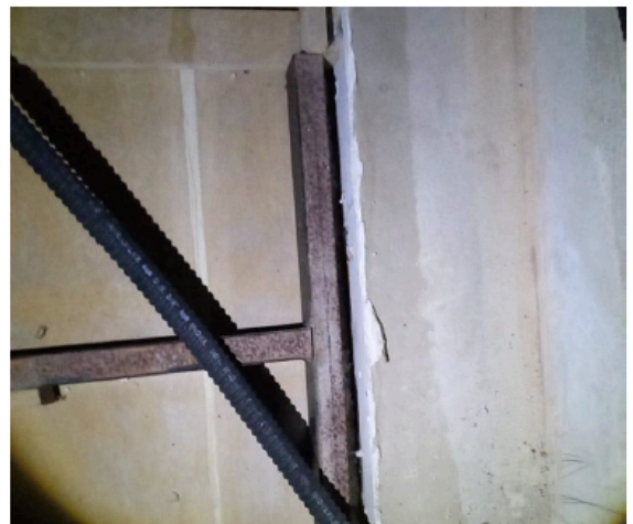
Suportes metálicos do forro oxidados
