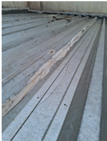
Tentativa de vedação com PU
