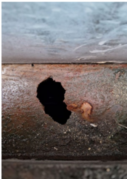
Outra calha oxidada e furada
