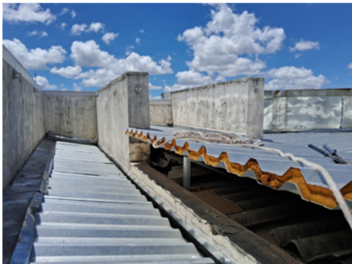
Telhado sem fechamento e mal projetado/planejado/executado
