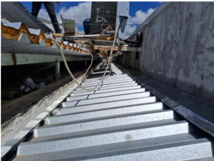
Telhado mal projetado e calhas e rufos mal instalados
