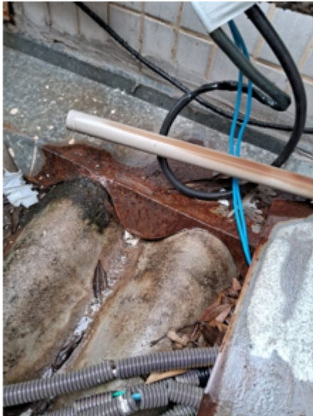
Calha enferrujada e fios soltos
