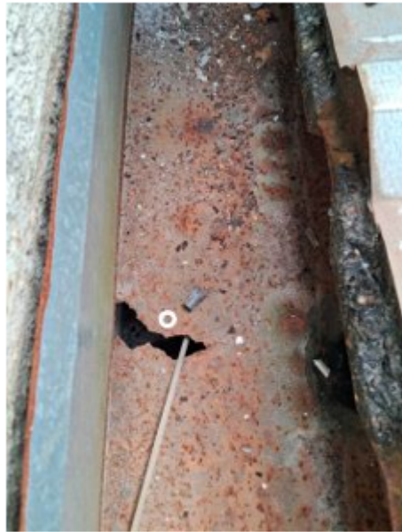
Calha sem vedação, enferrujada
