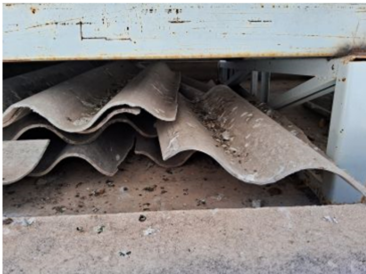
Depósito de restos de obras e ocupados por pombos em baixo do telhado sem fechamento
