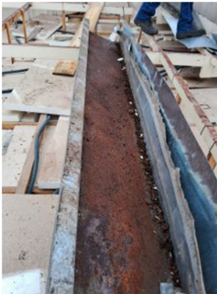
Calha que estava embaixo de outra calha
