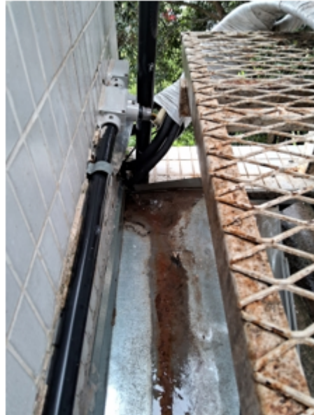
Calhas empoçando água
