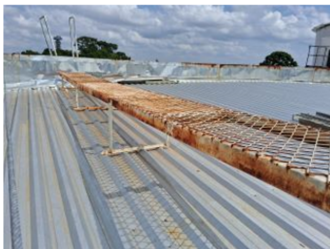
Plataformas mal executadas/fixadas e enferrujadas
