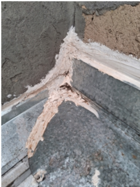
Platibanda desprotegida, PU
