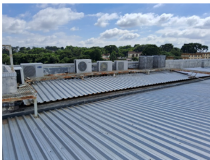
Telhado mal projetado (curto) e plataformas enferrujadas
