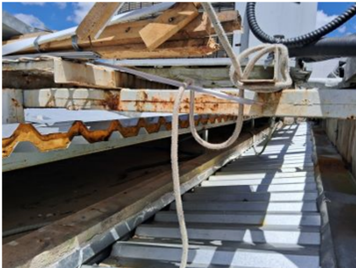
Plataforma enferrujada, instalada de forma que atrapalha a manutenção das calhas
