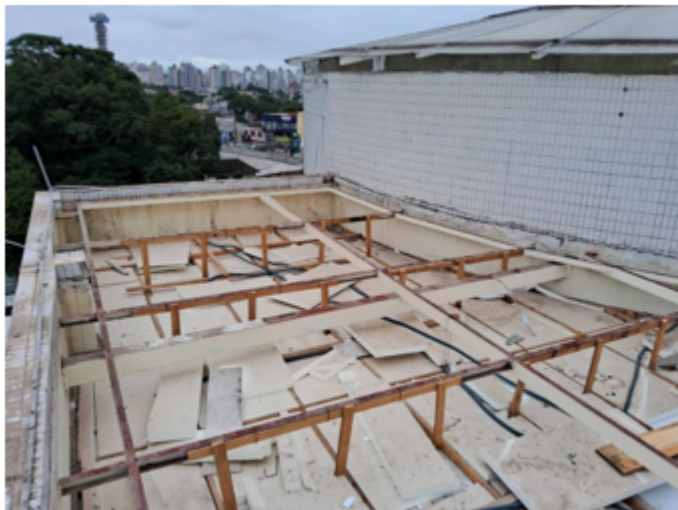
Madeiramento insuficiente para suportar as telhas
