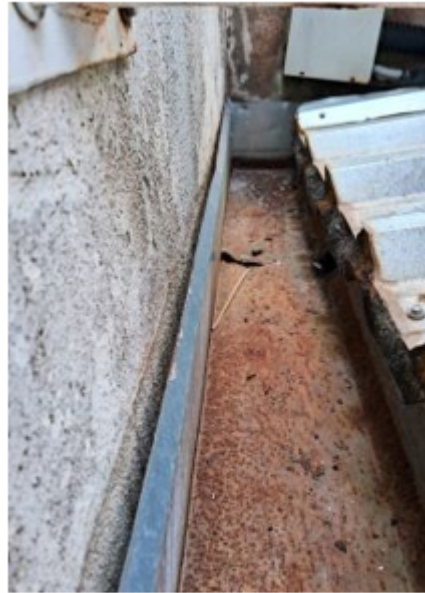
Calha sem vedação na parede c/ furo
