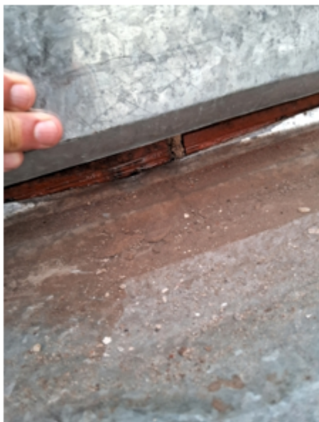
Rufo mal executado, infiltrando
