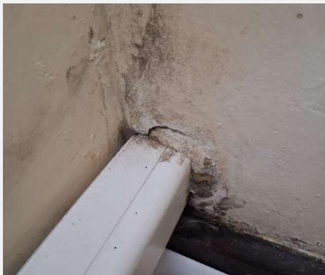
Manchas acentuadas, infiltração e mofo
