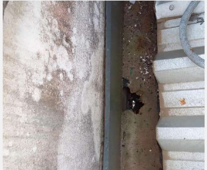
Calha furada, com corrosão, lama e sujeira
