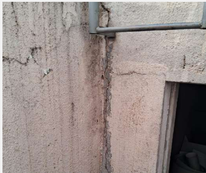
Paredes e estruturas com rachaduras, acabamento danificado e infiltração
