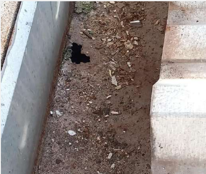
Calha furada, com corrosão, lama e sujeira
