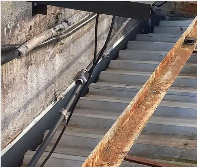
Estrutura com longa extensão de ferrugem
