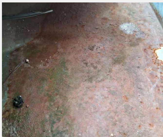
Calhas entupidas, com lama, sujeira e proliferação de musgos e mofo
