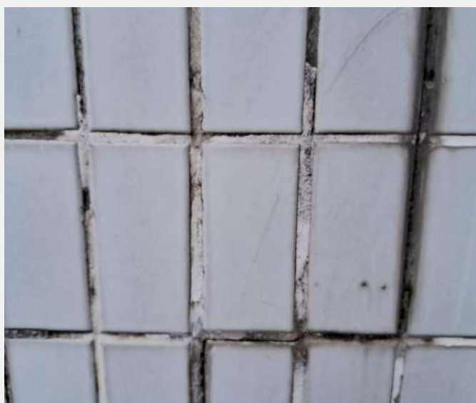
Fachada com manchas acentuadas, trincas e dilatação
