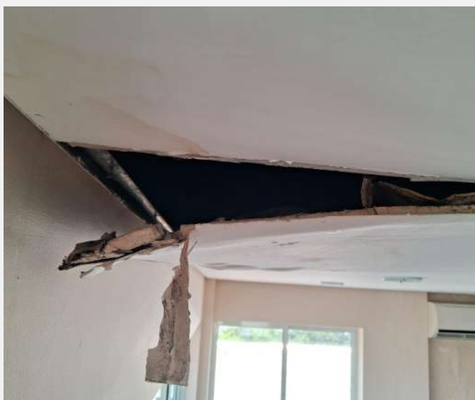
Forro danificado, com infiltração e mancha de mofo
