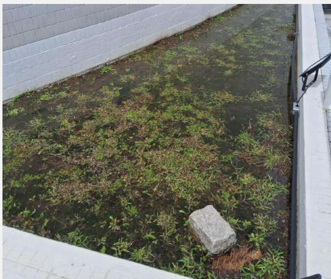
Entupimento da drenagem dos jardinetes que acarretaram em infiltrações no auditório
