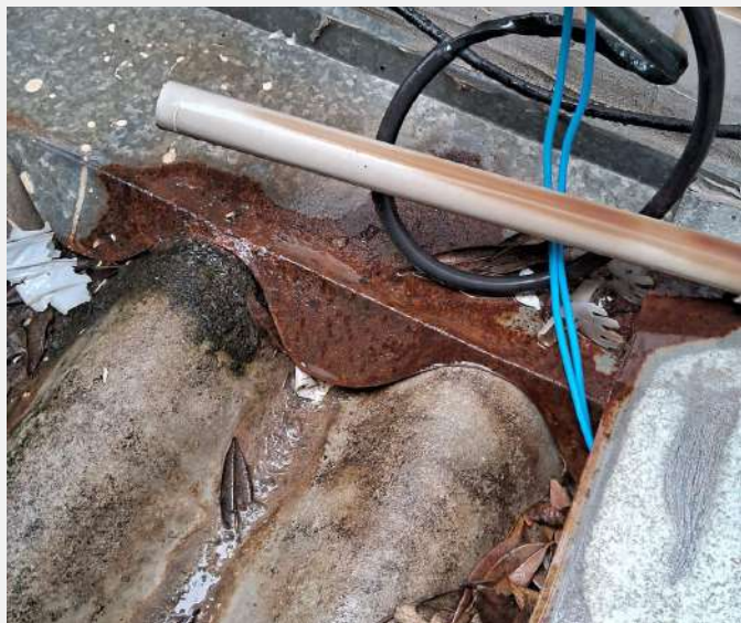
Fiação, calha e telhado sem acabamento adequado
