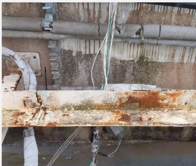
Fiação pendurada, exposta, sem isolamento correto e emendas mal executadas
