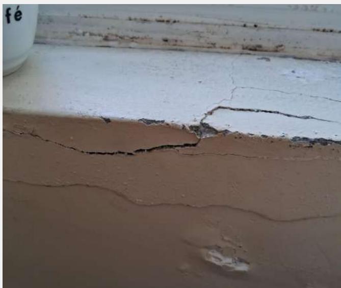
Área com perda de revestimento, rachaduras e sinais de eflorescência
