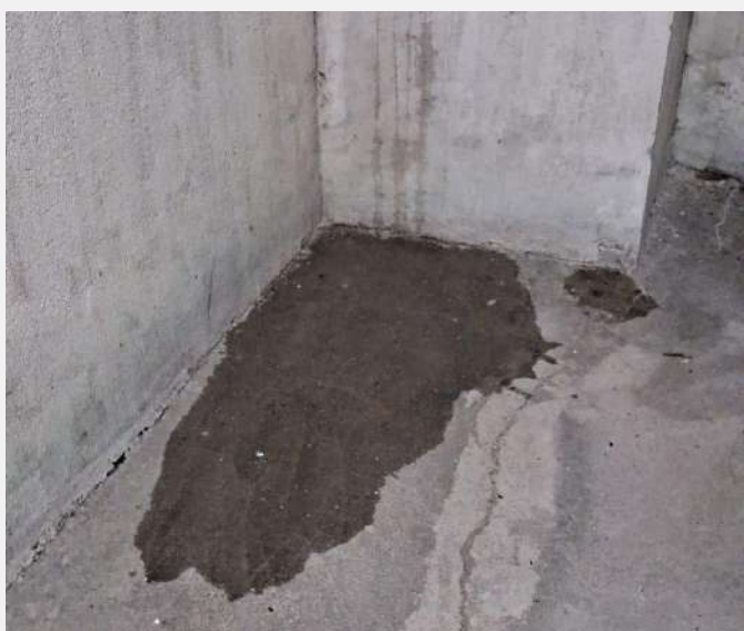
Presença de trincas e infiltração
