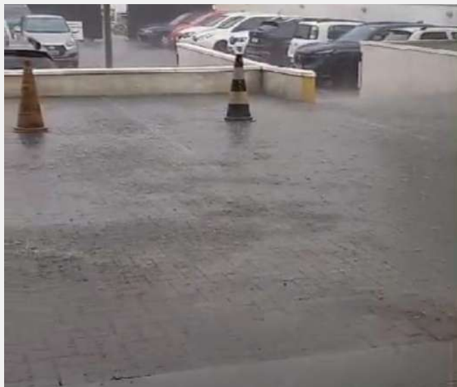
Inundação em dias chuvosos causada pela má nivelção e falha na drenagem
