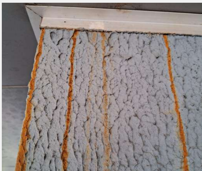
Manchas de ferrugem e infiltração
