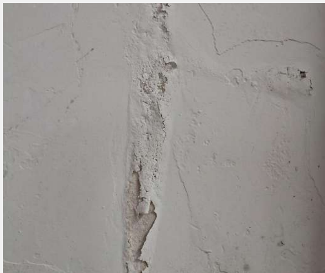
Parede com infiltração e desprendimento de revestimento
