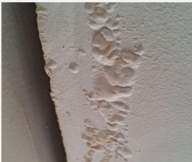
Revestimento danificado pela infiltração e umidade
