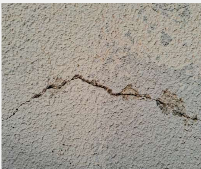
Paredes da fachada com rachaduras extensas que estão causando infiltrações
