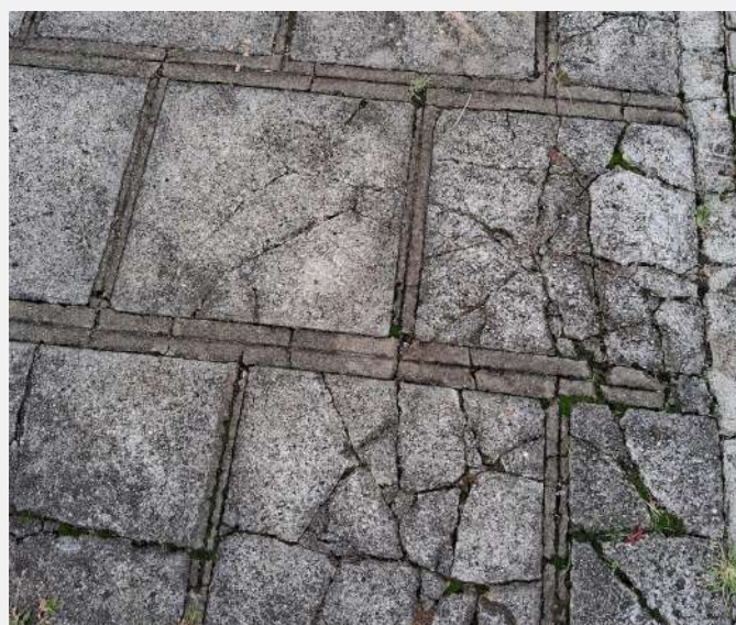
Revestimento das calçadas rachado e desgaste no acabamento
