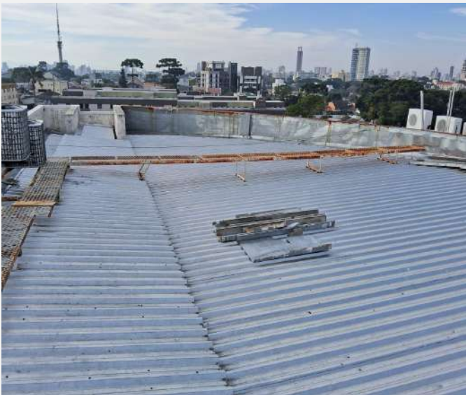
Estruturas com ferrugem e sistemas de fixação da passarela danificados
