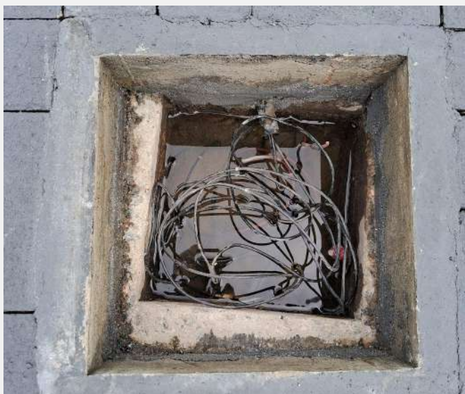
Fiação emaranhada, imersa em água, sem proteção, oferecendo riscos
