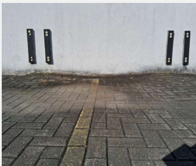
Má nivelção da área de estacionamento e manchas causadas pela água
