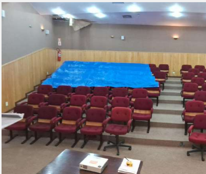
Auditório interditado com infiltração, goteiras e forro danificado pela umidade
