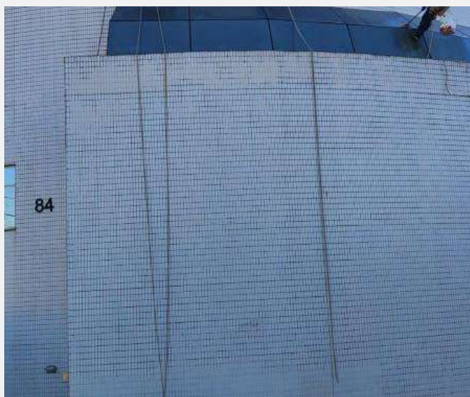
Superfície com pastilhas soltas e presença de sujeira
