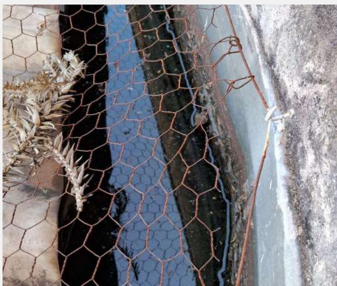
Calhas sujas entupidas e inundadas
