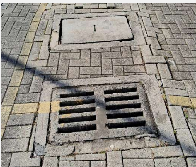
Sistema de drenagem mal nivelado e com trincas e rachaduras
