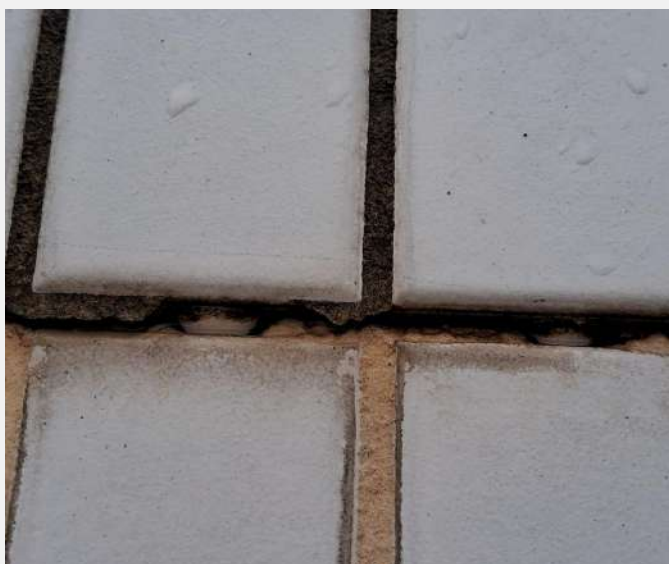
Revestimento cerâmico com manchas e presença de falhas no rejuntamento
