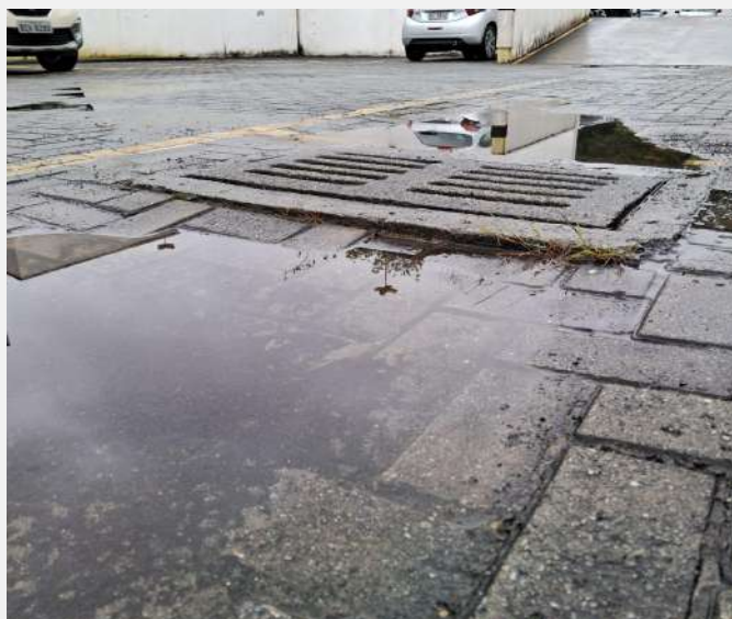
Má nivelção da área e sistema de drenagem falho
