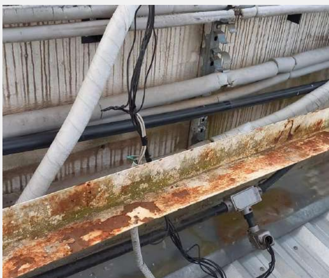
Fiação exposta, emaranhada e sem isolamento adequado
