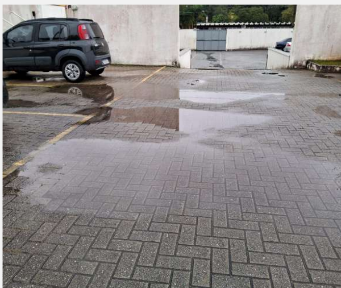
Estacionamento com poças grandes de água causadas pela má nivelção e sistema de drenagem falho
