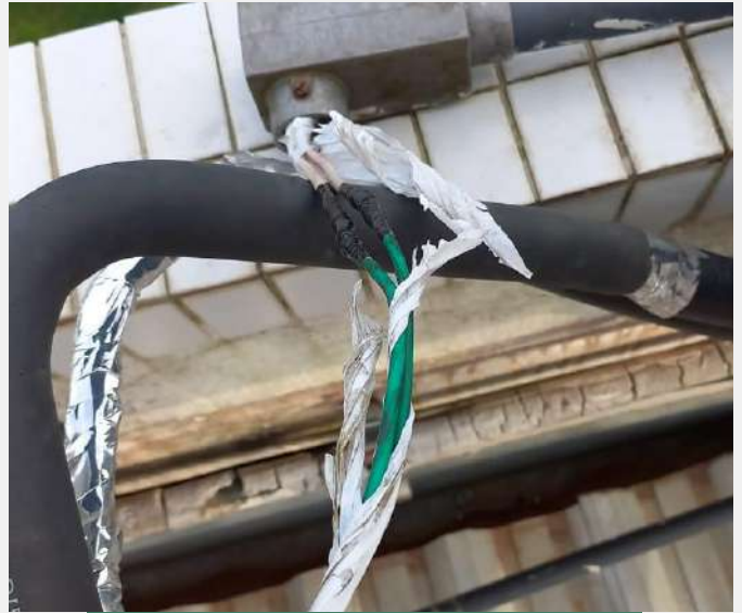
Fiação exposta ao ar livre sem isolamento adequado
