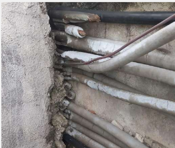
Tubulação mal executada, com cortes indevidos, presença de ferrugem e acabamento impróprio
