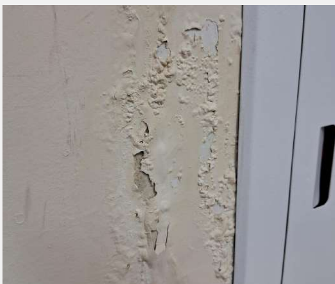
Infiltração e revestimento prejudicado
