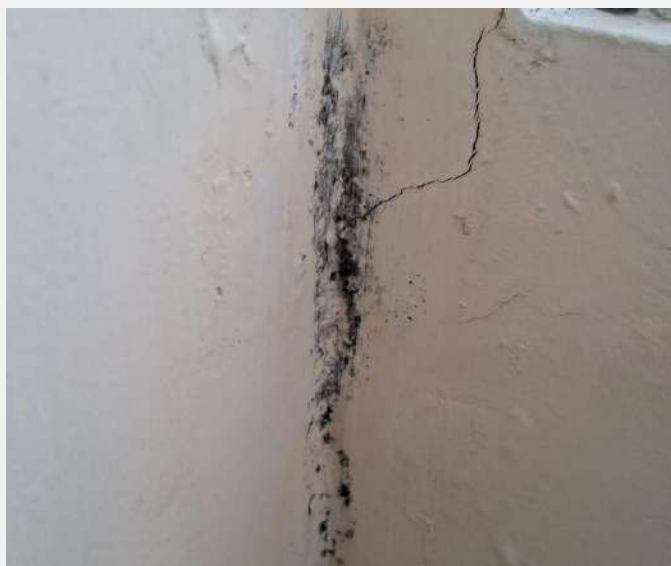
Rachaduras e manchas escuras, mofo por infiltração prolongada
