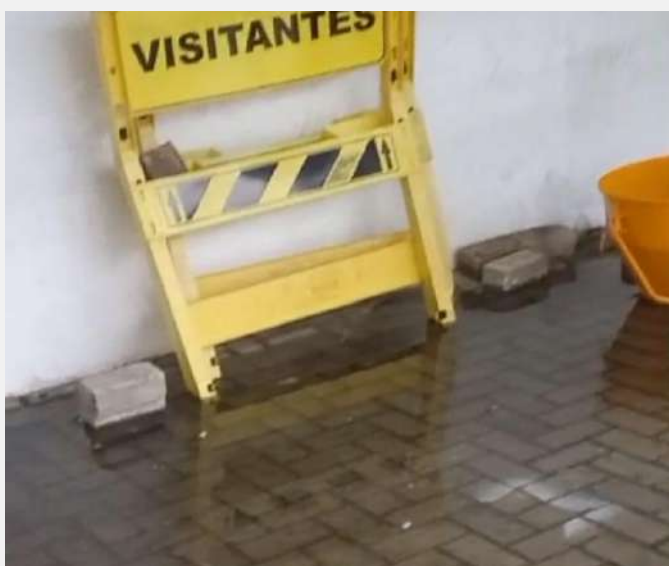
Má nivelção da área e sistema de drenagem falho, poças altas de água
