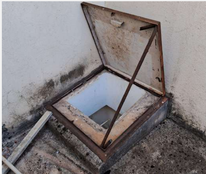
Acesso ao telhado sem condições de uso, totalmente enferrujado
