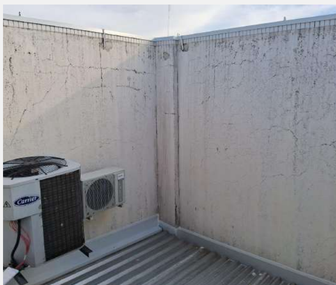
Paredes e estruturas com rachaduras extensas, trincas e acabamento danificado
