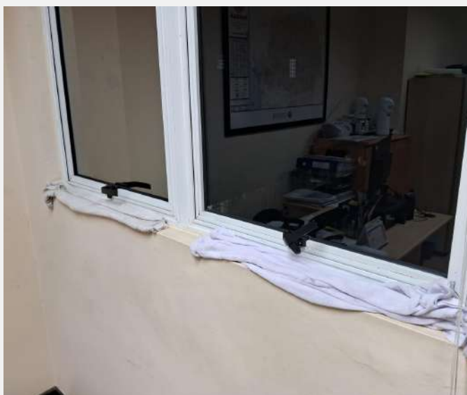
Panos encharcados pela água da chuva, infiltração na sala da Vice-Presidência
