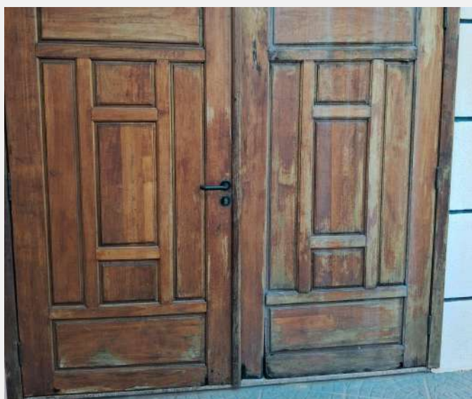
Portas corroídas, danificadas, tortas e com infiltração aparente
