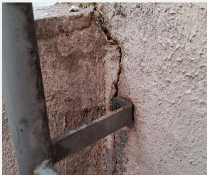
Paredes com rachaduras extensas, acabamento danificado e problemas no sistema de fixação
