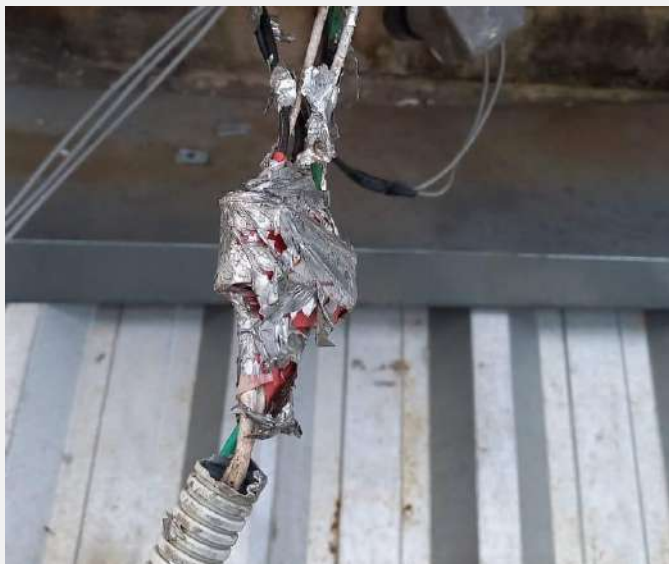
Fiação exposta, pendurada, sem proteção adequada e sem isolamento
