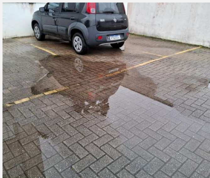
Estacionamento com poças grandes de água causadas pela má nivelção da área
