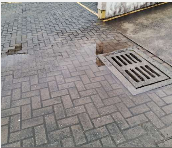
Má nivelção e falha na drenagem
