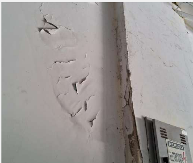
Parede prejudicada pela infiltração com trincas e camadas descascando
