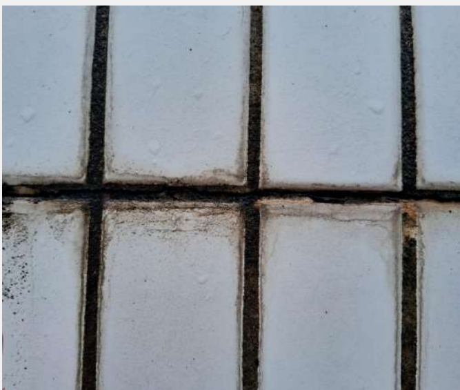
Parede com manchas, pastilhas soltas e degradação visível
