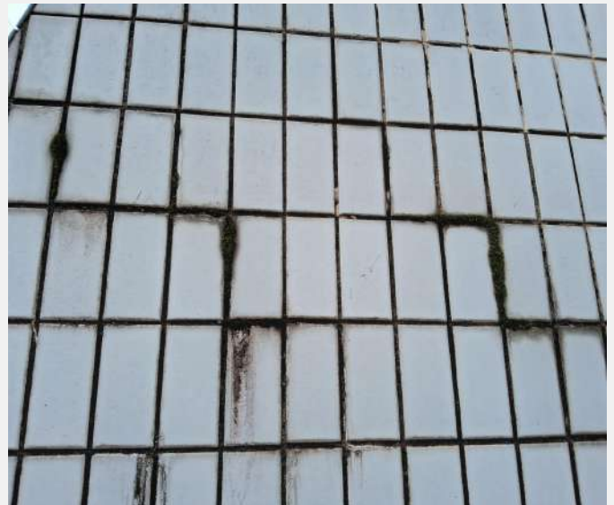
Presença de manchas esverdeadas, indicando proliferação de algas
