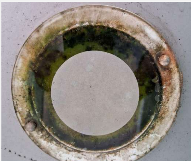
Luminária danificada, com umidade, infiltração e proliferação de musgos
