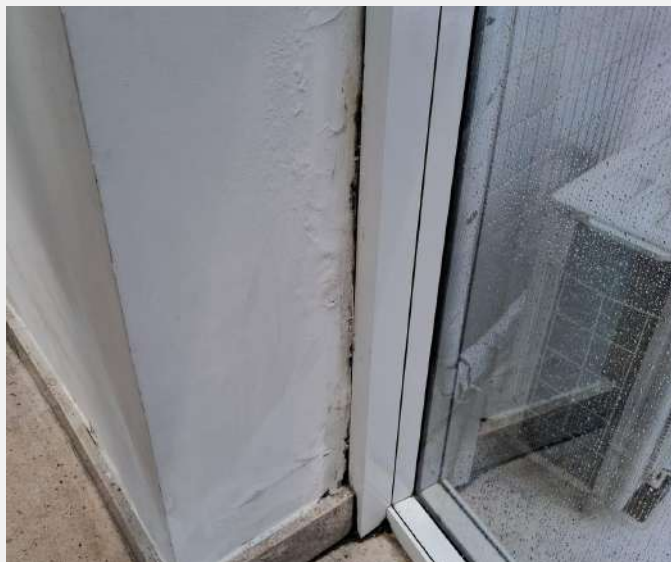
Presença de trincas, mofo e infiltração
