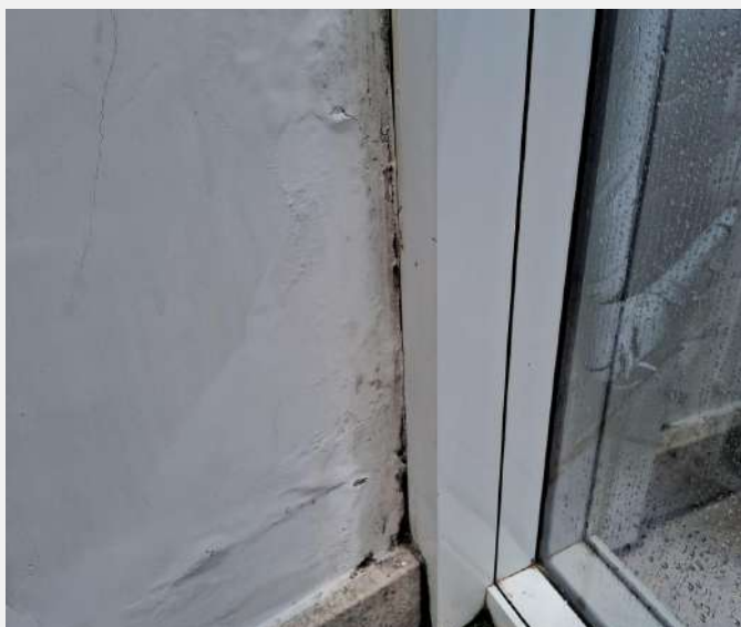
Presença de trincas, mofo e infiltração
