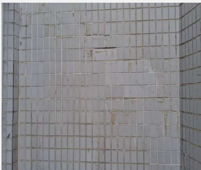
Pastilhas descoladas, falhas no rejunte e manchas de umidade
