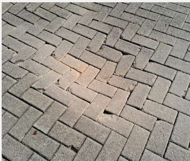
Área de estacionamento mal nivelada e cedendo
