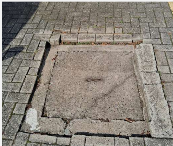
Tampas de caixas de passagem comprometidas
