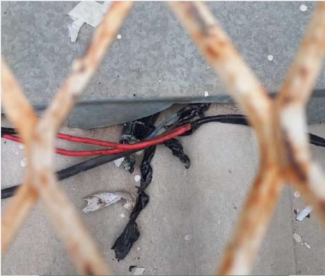
Fiação exposta sem isolamento adequado
