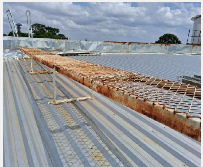
Passarelas com ferrugem e corrosão
