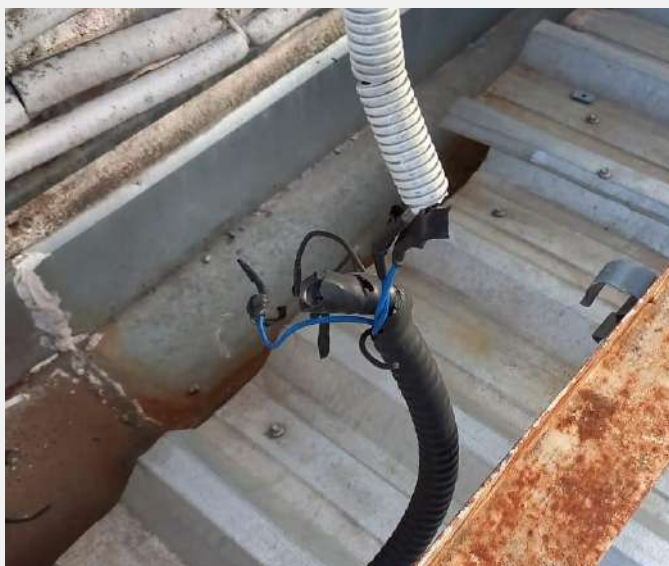
Fiação exposta, com isolamento inadequado
