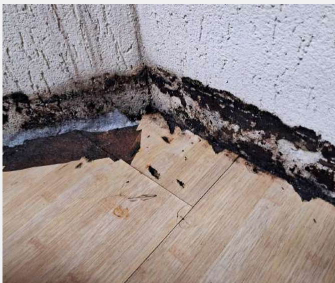
Piso totalmente comprometido com infiltração, mofo e manchas biológicas
