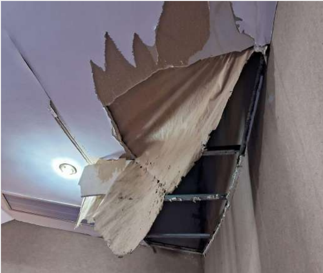
Forro solto e estrutura danificada
