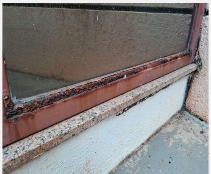
Portas e esquadrias com ferrugem e corrosão
