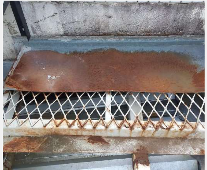
Telhado e calha com ferrugem
