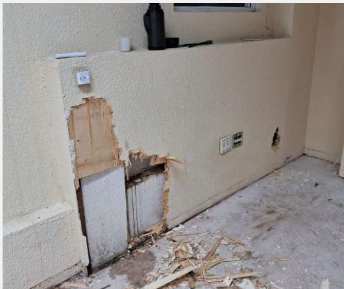
Parede com manchas, revestimento afetado e infiltração
