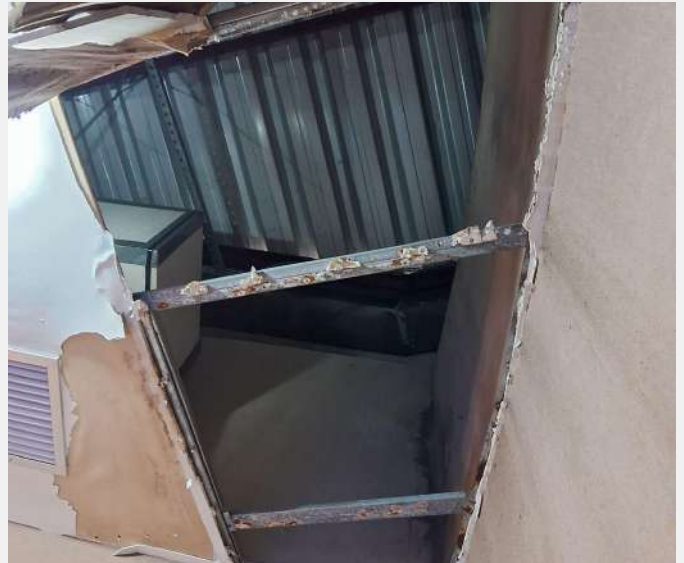
Forro solto e estrutura danificada
