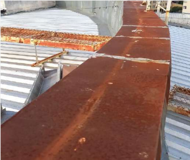
Calhas e rufos enferrujados e comprometidos
