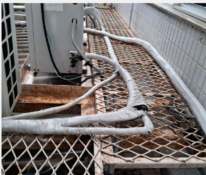
Estrutura do ar-condicionado danificada, fios expostos e ferrugem
