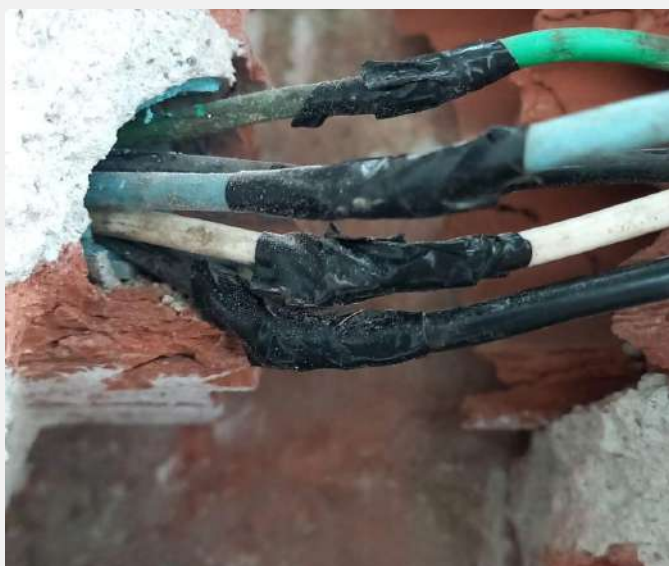
Fiação exposta e sem isolamento adequado
