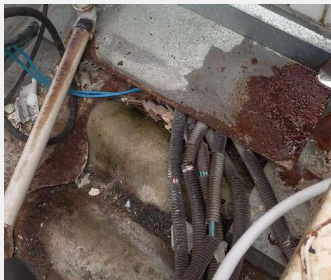
Fiação, calha e telhado sem acabamento adequado
