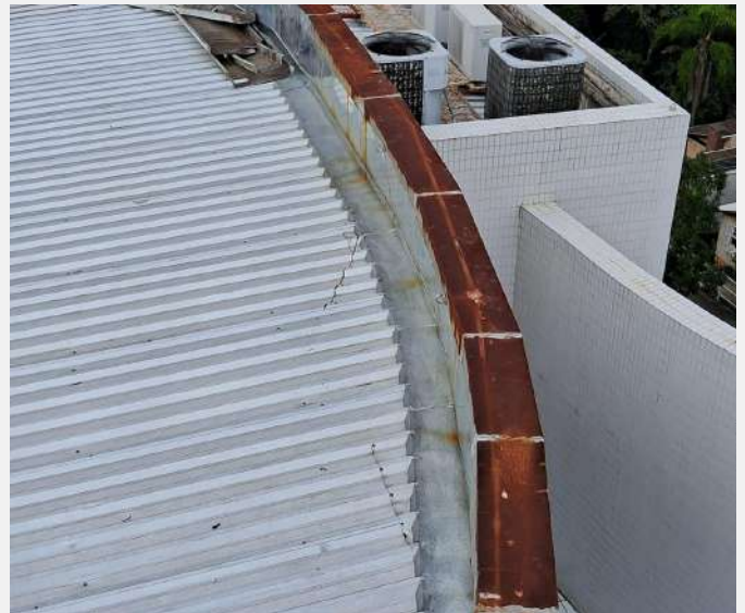
Estruturas com ferrugem e corrosão, sistemas de fixação danificados
