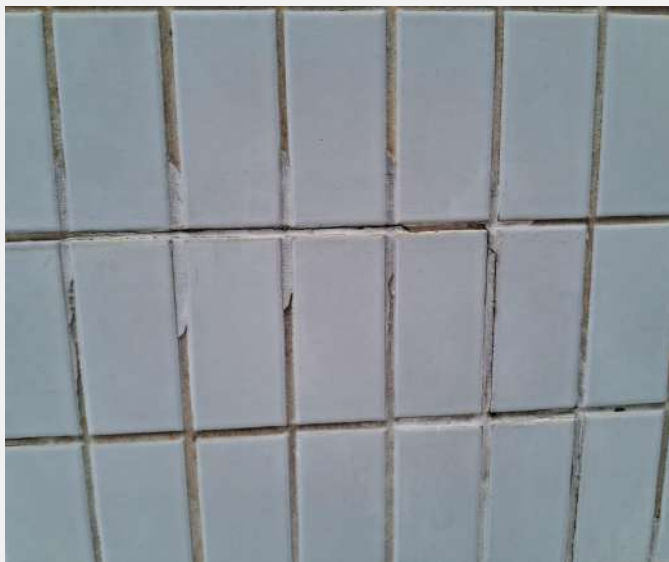
Pastilhas com manchas e sinais de umidade
