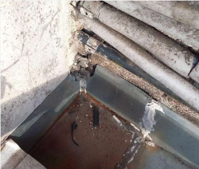
Calha com corrosão, ferrugem e sujeira
