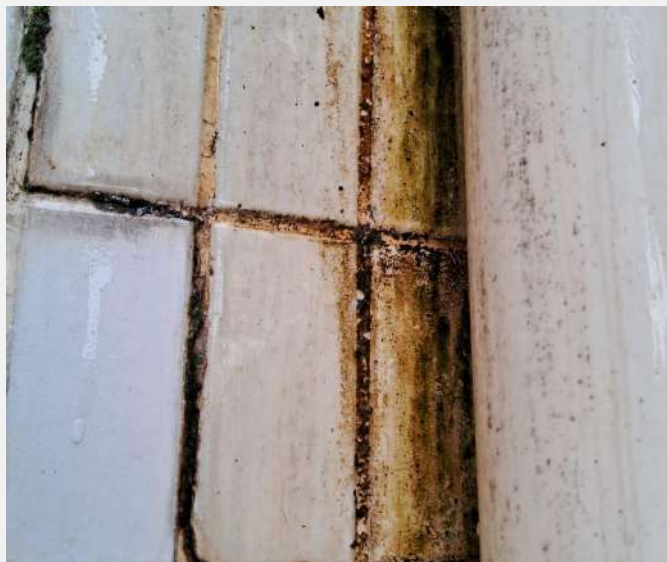
Manchas acentuadas e escuras, sinais de umidade
