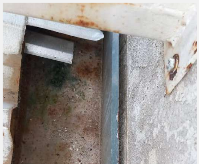
Calha com ferrugem e sujeira, sem vedação
