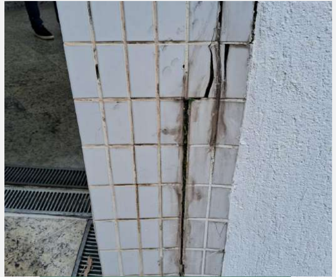
Revestimento com manchas e fissuras por dilatação
