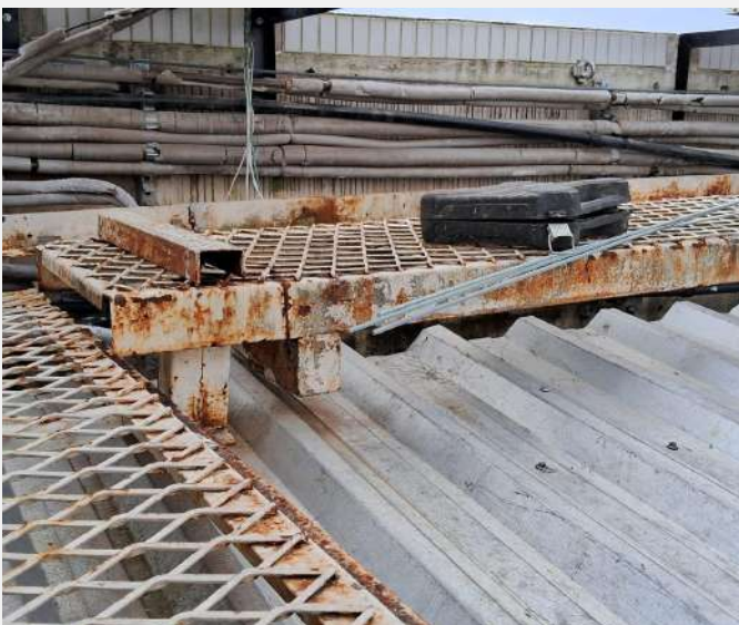
Passarelas com ferrugem e corrosão
