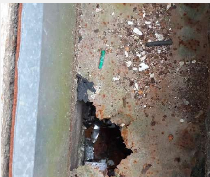
Calha furada, com corrosão, lama e sujeira
