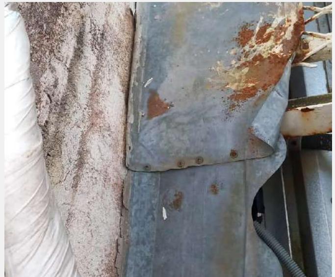
Calhas soltas, enferrujadas e danificadas
