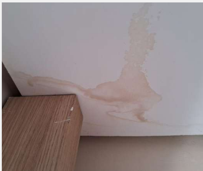
Manchas, infiltração e presença de mofo
