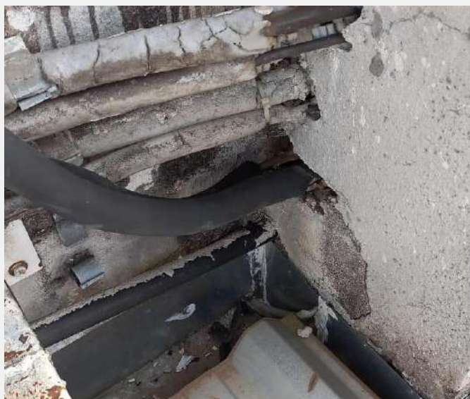
Tubulação mal executada, com cortes indevidos e acabamento impróprio
