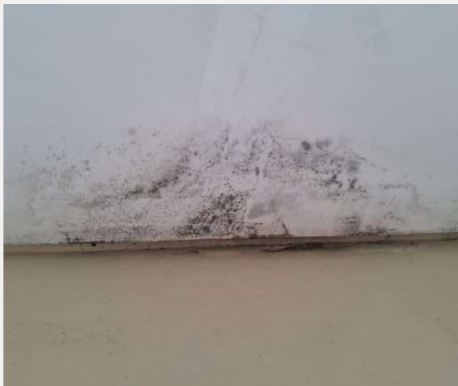
Infiltração, mofo e manchas por umidade
