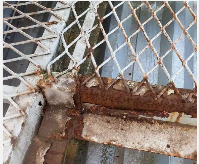
Ferrugem e corrosão na estrutura
