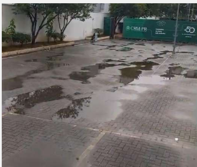
Poças de água causadas pela má nivelção da área e sistema de drenagem falho
