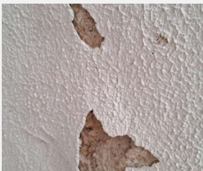
Revestimento descascando e presença de infiltração
