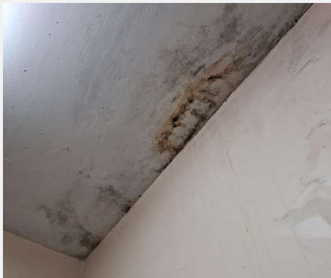
Parede com revestimento falho, acúmulo de mofo e infiltração
