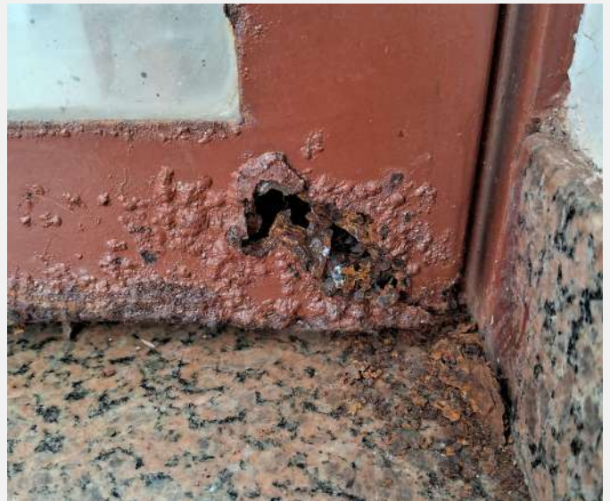
Portas com ferrugem e corrosão
