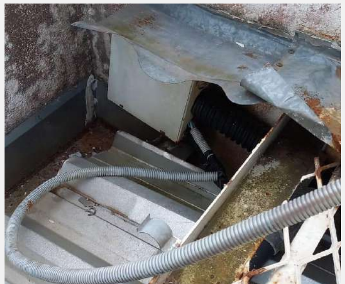
Calhas danificadas, ferrugem na estrutura e elétrica mal executada
