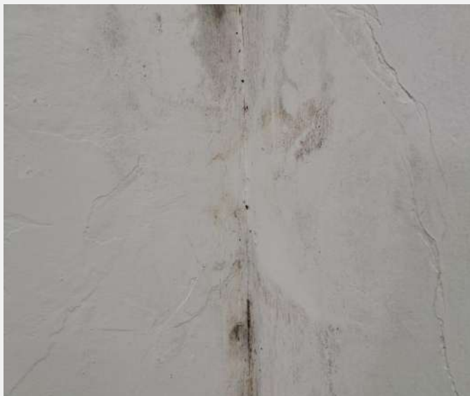
Áreas de falha no revestimento, trincas e manchas evidentes de mofo
