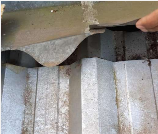
Calhas soltas e danificadas
