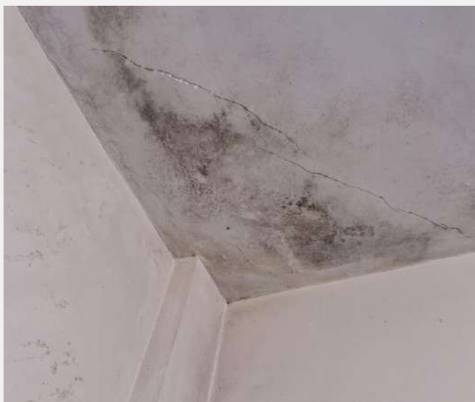
Mofo por infiltração, trincas e manchas escuras
