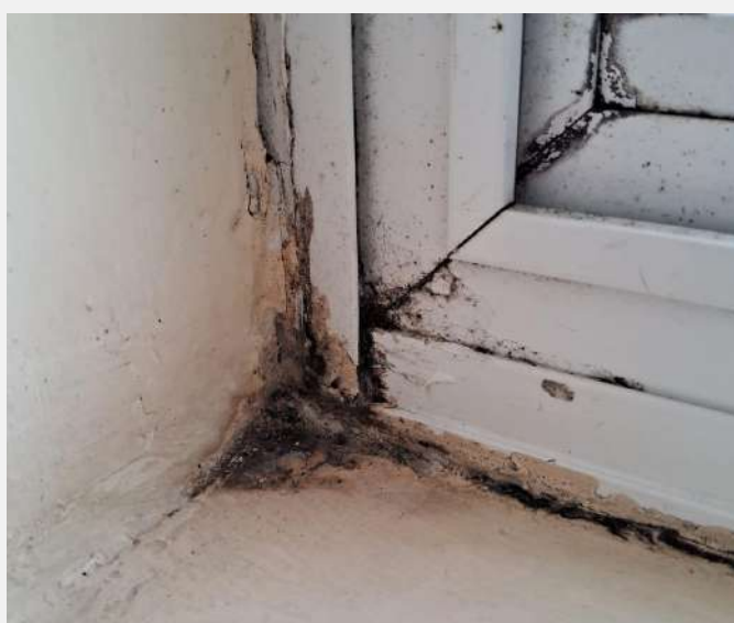
Manchas, mofo e sinais de umidade
