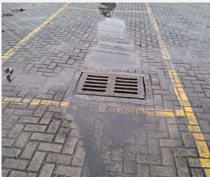
Má nivelção da área e sistema de drenagem falho, poças extensas
