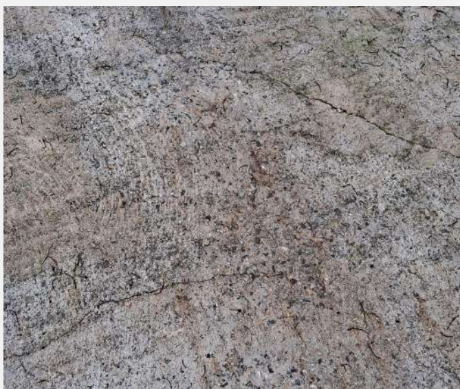
Trincas extensas nos revestimentos da rampa
