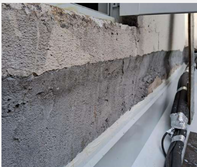
Estrutura danificada com acabamentos indevidos
