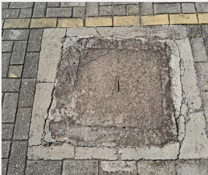
Tampas de caixas de passagem comprometidas
