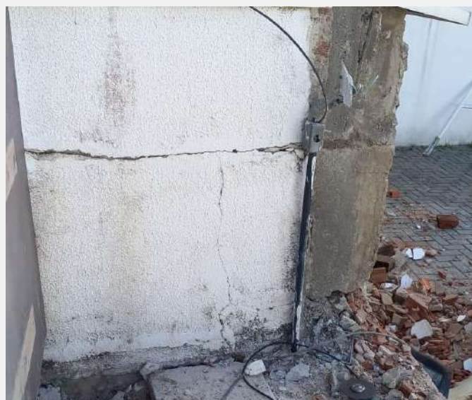
Paredes com trincas, rachaduras estruturais em viga de concreto e partes despedaçadas
