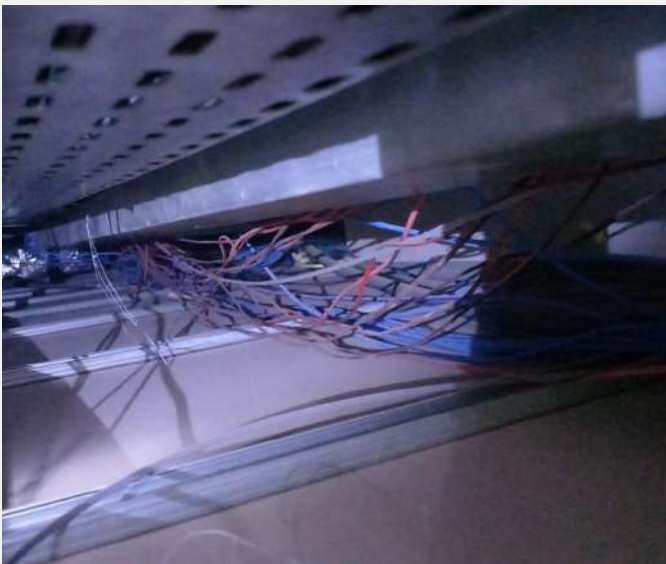
Fiação desorganizada e solta por dentro do forro
