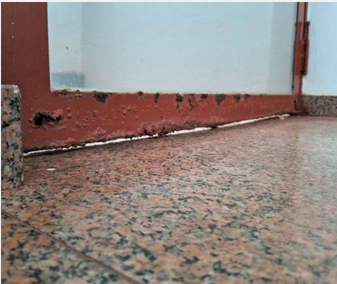
Portas com ferrugem e corrosão
