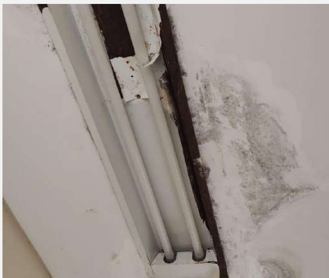
Parte elétrica com infiltração, mofo e calha apodrecida
