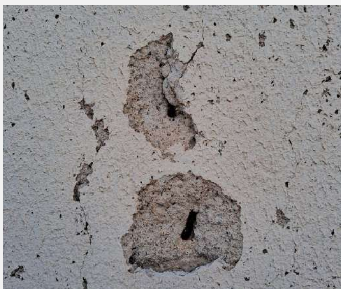
Pontos de ferrugem nos embossos de fachada
