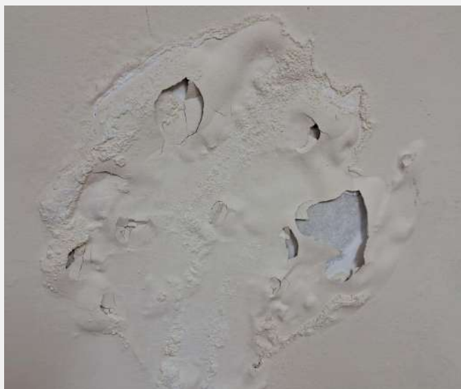
Infiltração e revestimento prejudicado
