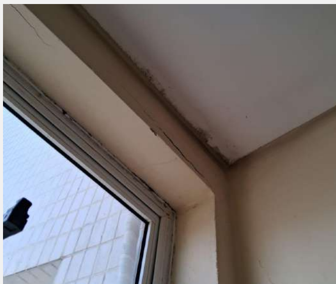
Rachaduras, falhas no revestimento e presença de mofo por infiltração
