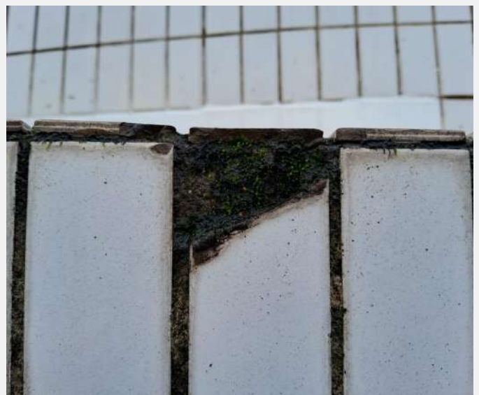
Parede com manchas, pastilhas soltas e degradação visível
