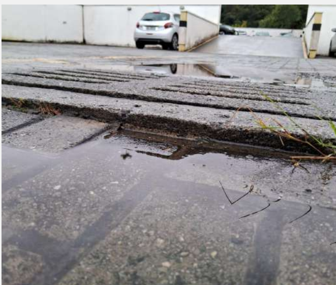
Área com sistema de drenagem falho e má nivelção
