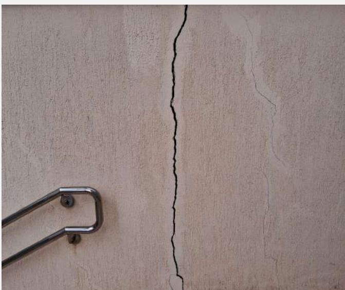
Rachaduras extensas e presença de trincas
