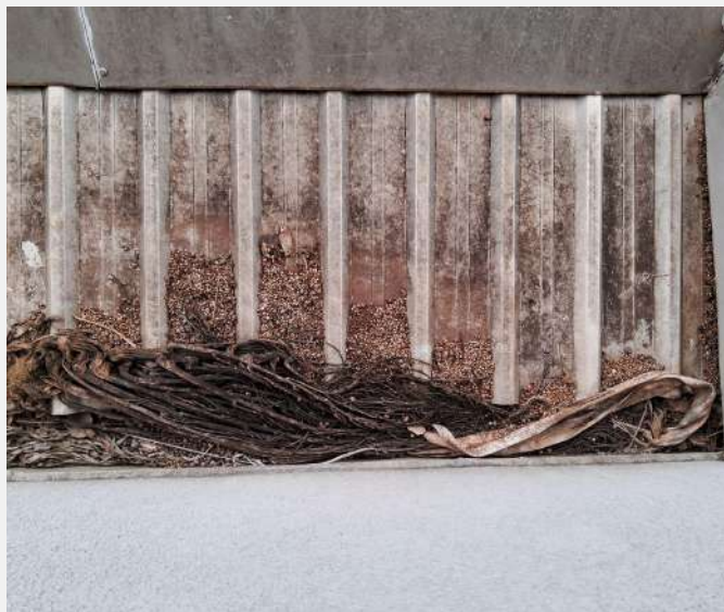
Calhas entupidas, sujas e com falta de manutenção
