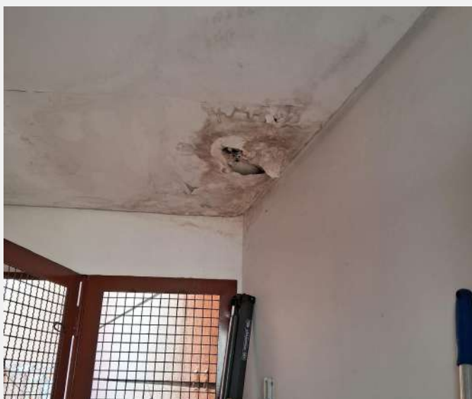
Forro danificado, com manchas de mofo e bolor e infiltração aparente
