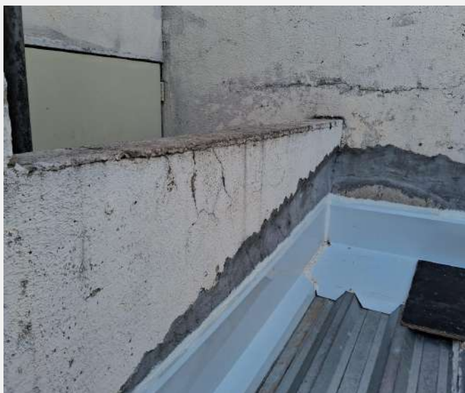
Paredes externas danificadas, com trincas, rachaduras e falhas no embosso
