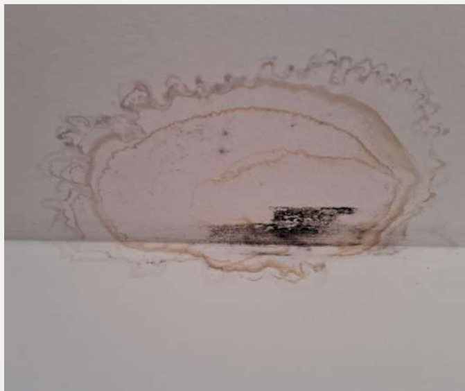
Manchas, infiltração e presença de mofo e bolor
