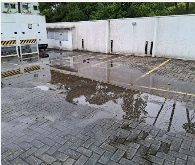
Estacionamento com má nivelção da área e sistema de drenagem falho
