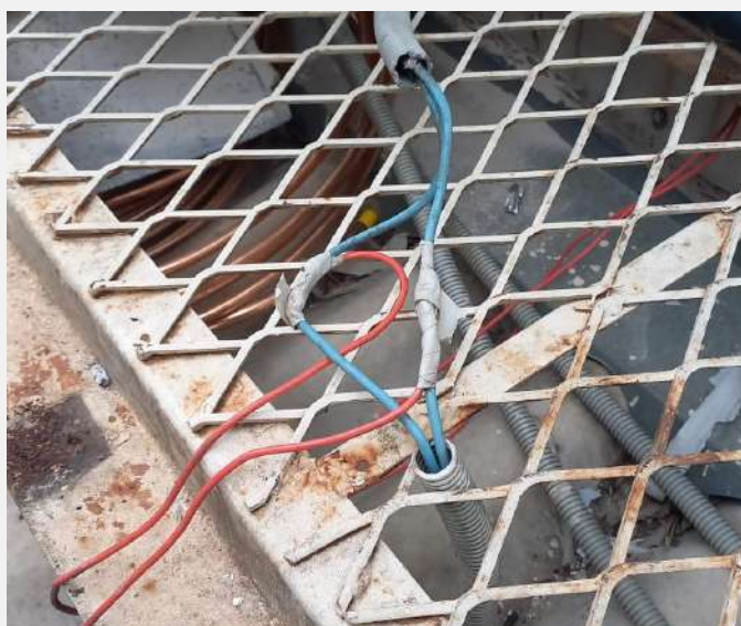
Fiação exposta com diversas emendas inadequadas
