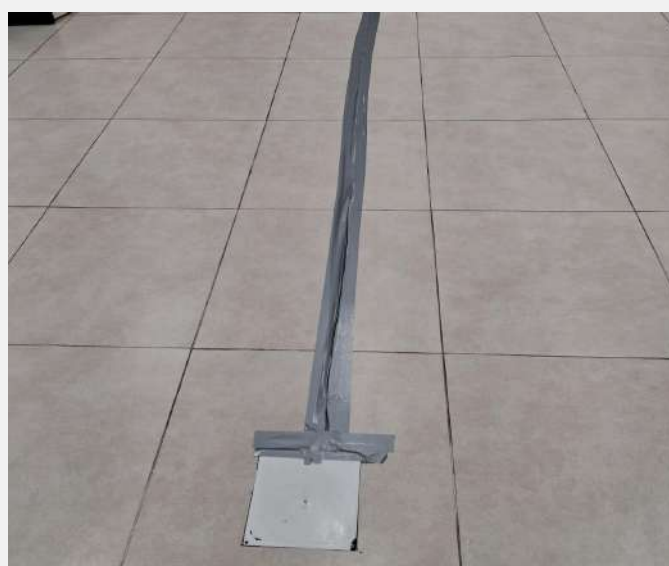
Fiação exposta, presa de forma inadequada oferecendo riscos
