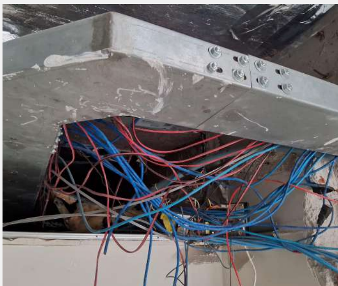
Fiação desorganizada, solta e sem identificação
