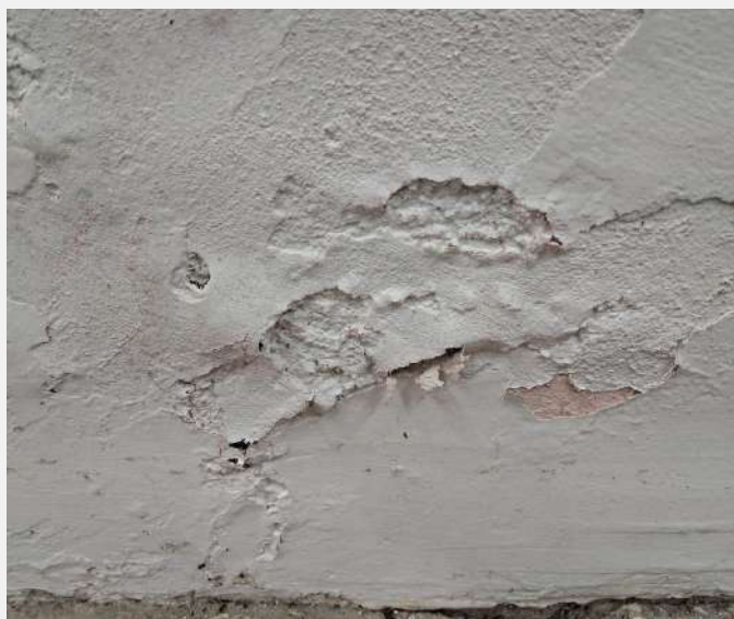
Parede com sinais evidentes de infiltração e falha no revestimento
