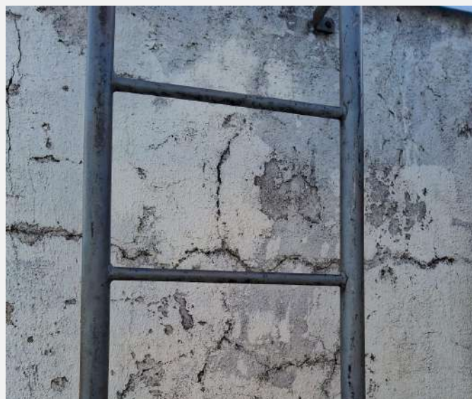
Escada solta, paredes de suporte com rachaduras extensas e acabamento danificado
